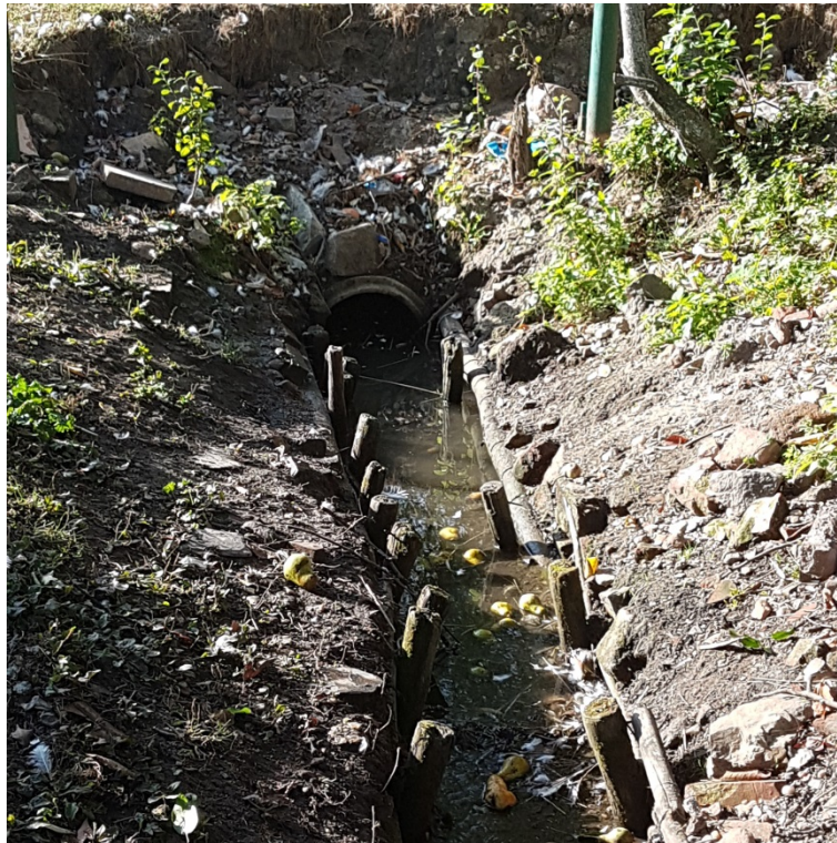
Przepust 4 w osi rowu CL-2-30 do przebudowy.
