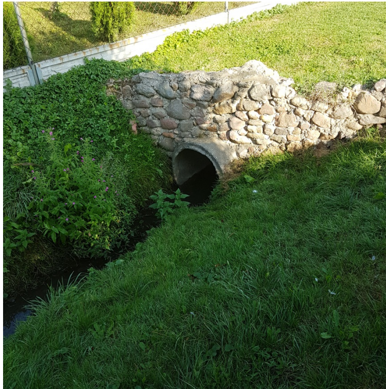
Przepust 2 w osi rowu CL-2-30 do przebudowy.
