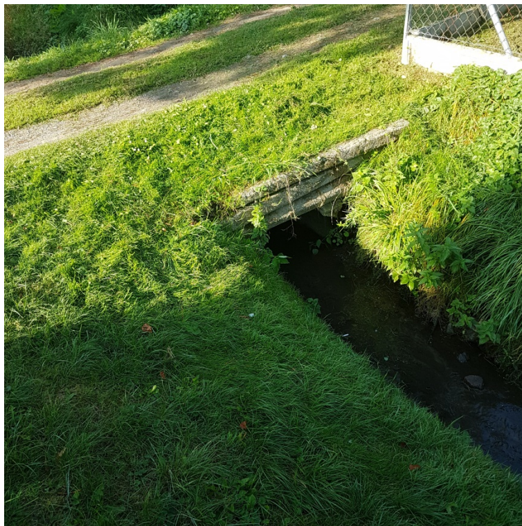
Przepust 3 w osi rowu CL-2-30 do przebudowy.
