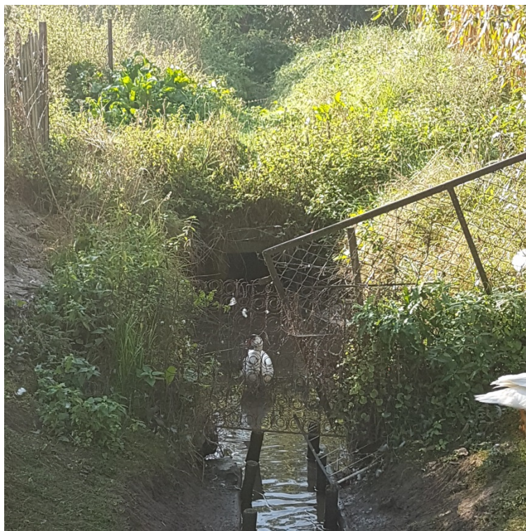
Przepust 5 w osi rowu CL-2-30 do przebudowy.
